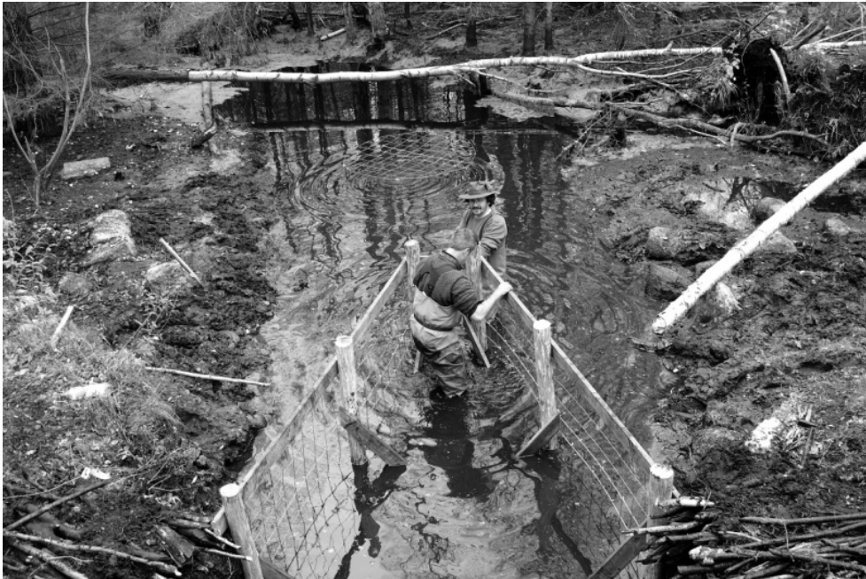
Ryc. 10. Ogrodzenie zabezpieczające przepust kolejowy zostało połączone rurą (pod wodą) z koszem z siatki. Bardzo skuteczne i długotrwałe zabezpieczenie.
