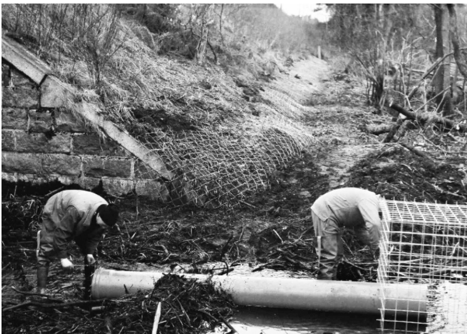
Ryc. 4. Zabezpieczenie grobli nasypu kolejowego za pomocą siatki. Jednocześnie został zabezpieczony przepust pod nasypem – rozwiązanie kompleksowe.
