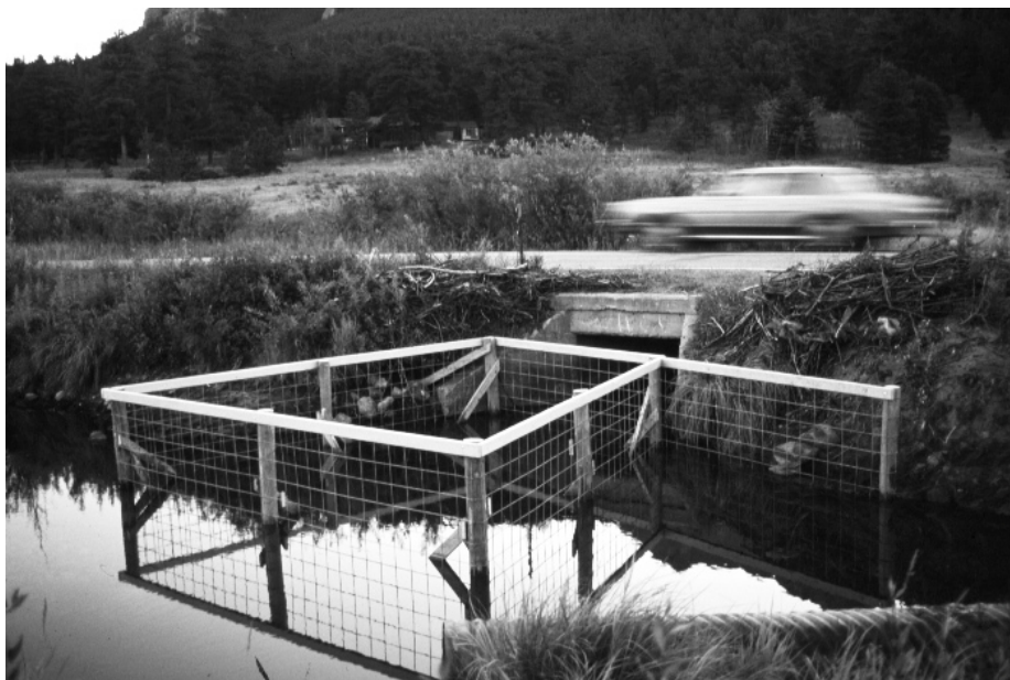
Ryc. 6. Ogrodzenie ochraniające przepust – zwróć uwagę na miejsce z prawej strony pozostawione do swobodnej migracji bobrów i innych większych zwierząt pod ruchliwą drogą. W przypadku bardzo ruchliwych dróg zaleca się również założenie ogrodzenia nad przepustem w celu zmuszenia bobrów do przechodzenia przepustem.
