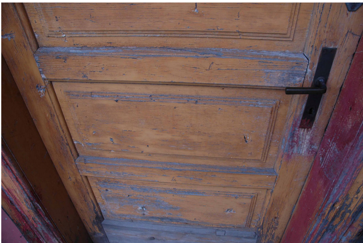
Fot. 13. Kościół p.w. Św. Michała Archaniola w Ropie. Zniszczona stolarka drzwiowa.
