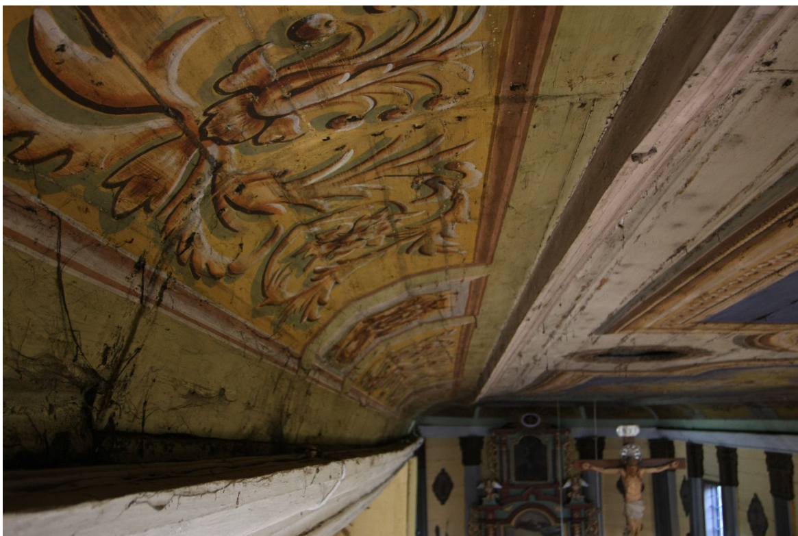
Fot. 20. Kościół p.w. Św. Michała Archaniola w Ropie. Polichromia na stropie fasetowym. Widoczne silne zabrudzenie powierzchni.
