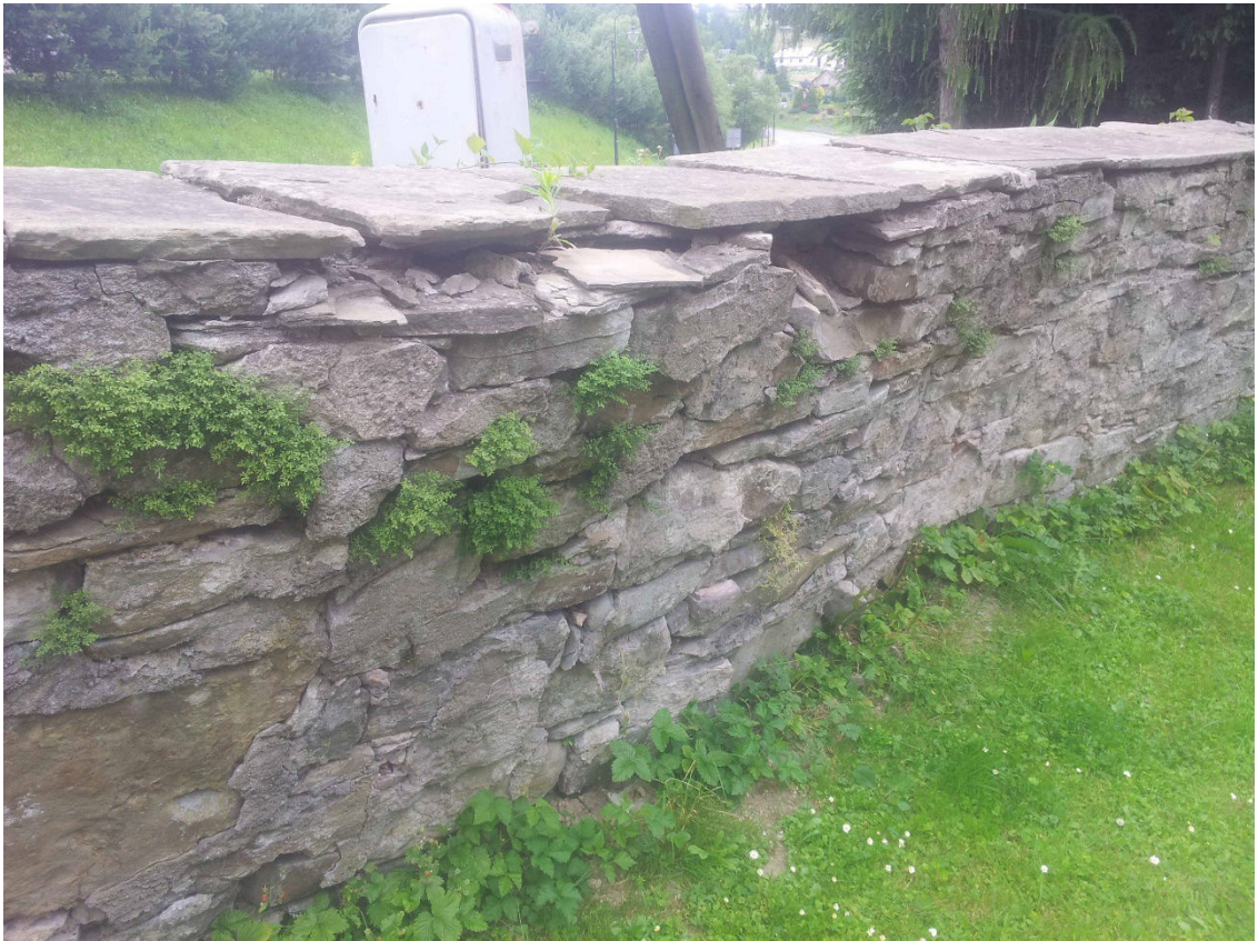
Fot 14. Kościół p.w. Św. Michała Archaniola w Ropie. Mur okalający. Widoczny przechyl oraz rozluźnienie struktury i ubytki kamienia.
