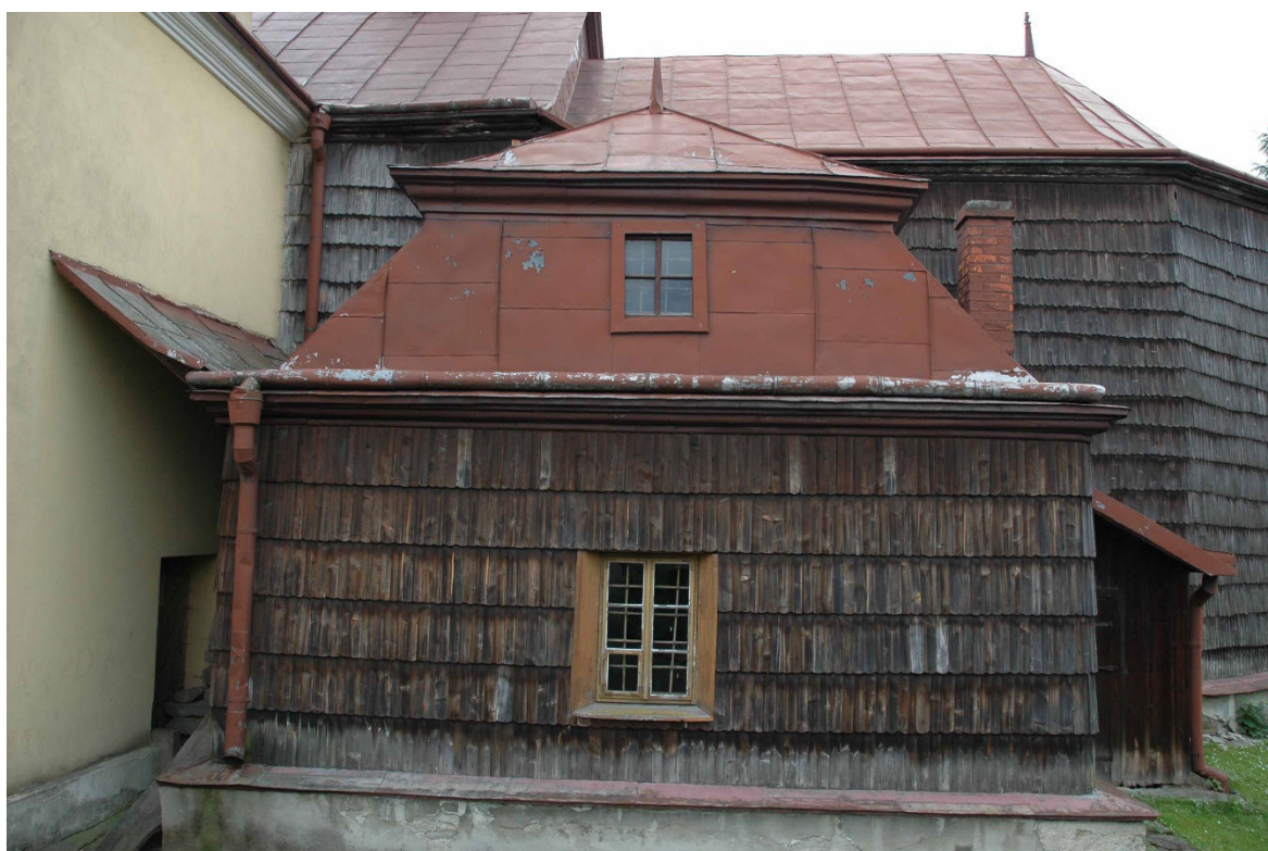
Fot. 5. Kościół p.w. Św. Michała Archaniola w Ropie. Widoczne pokrycie dachu oraz pokrycie ścian wykonane z gontów. Widok na zakrystię od strony zach. (west).
