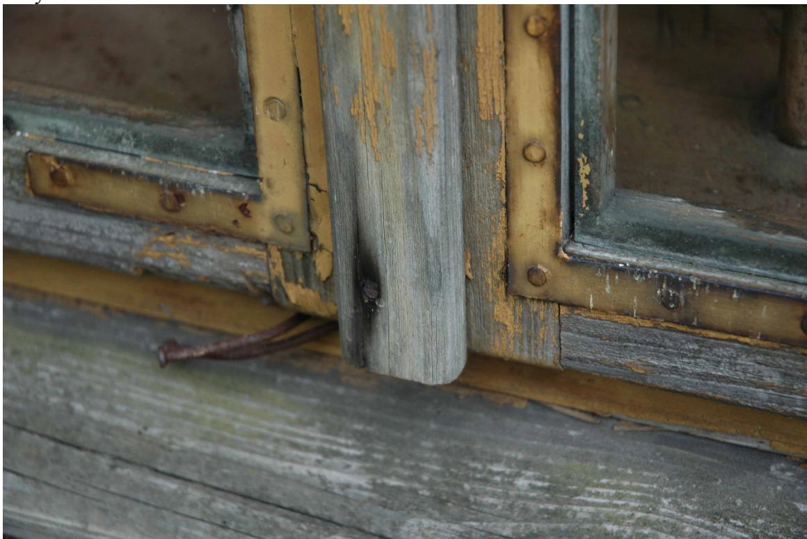
Fot. 12. Kościół p.w. Św. Michała Archaniola w Ropie. Zniszczona stolarka okienna.
