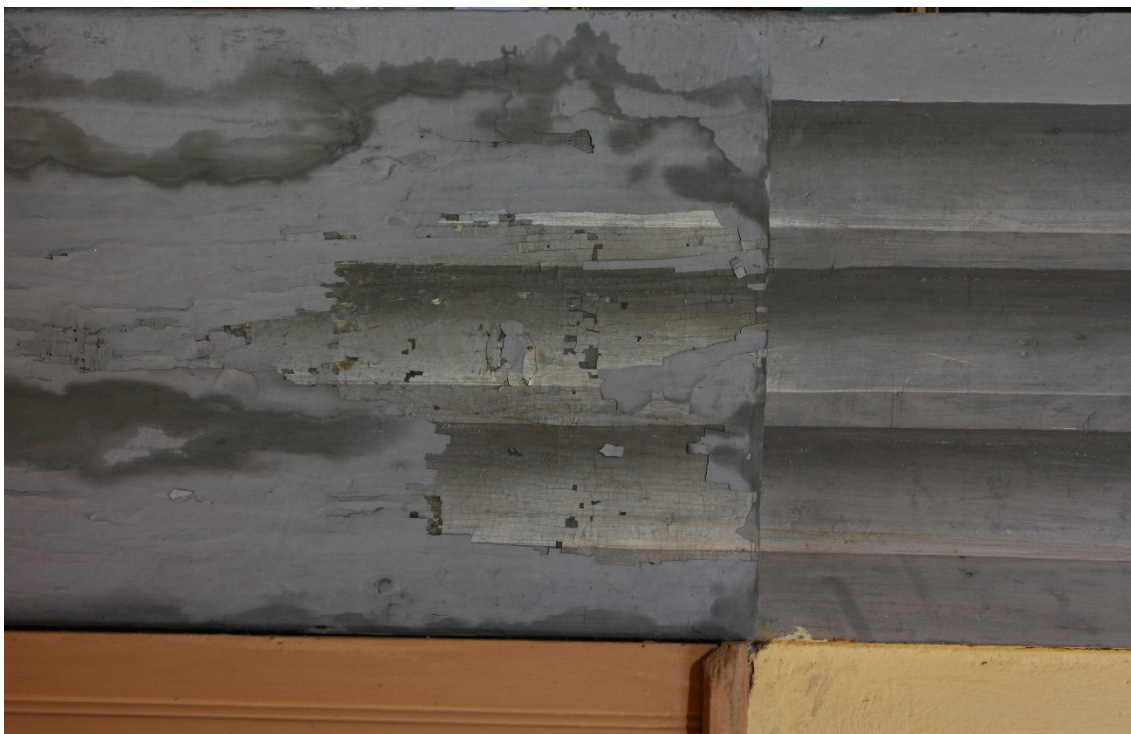
Fot.26. Kościół p.w. Św. Michała Archanioła w Ropie. Fragment polichromii na ścianie. Rozległe przemalowania i szlachetna warstwa modelunku na pierwotnej warstwie polichromii widoczna w ubytkach.
