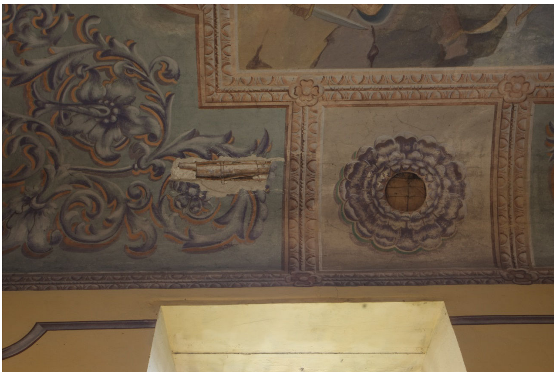
Fot.25. Kościół p.w. Św. Michała Archanioła w Ropie. Fragment polichromii na stropie kaplicy od strony wschodniej. Widoczny ubytek tynku wraz z warstwą malarską.
