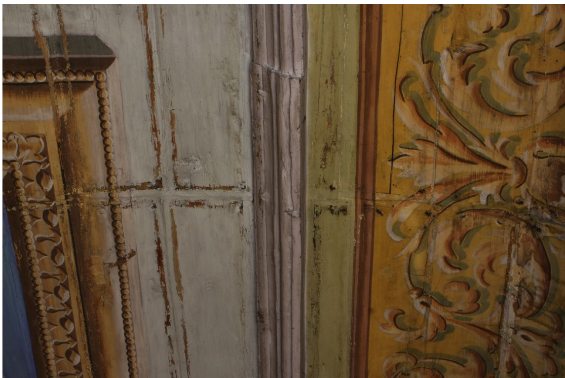
Fot.23. Kościół p.w. Św. Michała Archaniola w Ropie. Fragment polichromii na stropie fasetowym. Widoczne zniszczenia wywołane przez klej, którym przyklejano pasy płótna.
