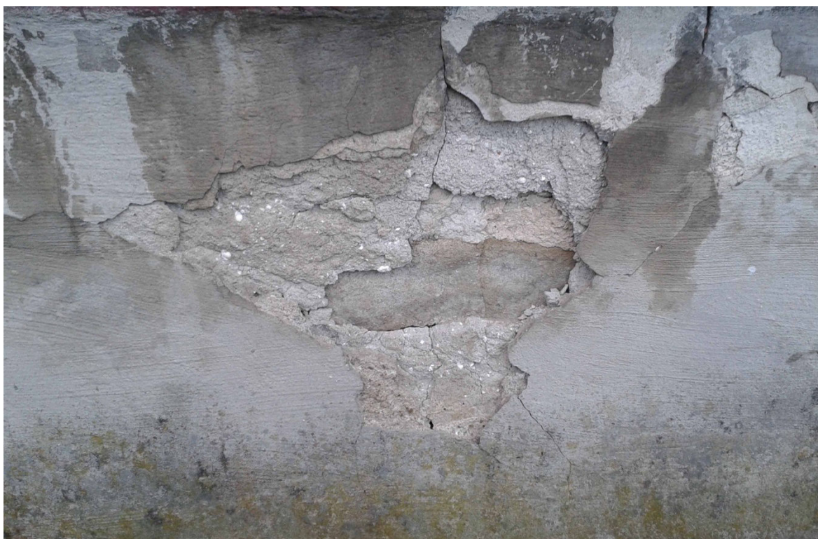
Fot. 8. Kościół p.w. Św. Michała Archanioła w Ropie. Widoczne rozległe uszkodzenia tynku na elewacji wież.
