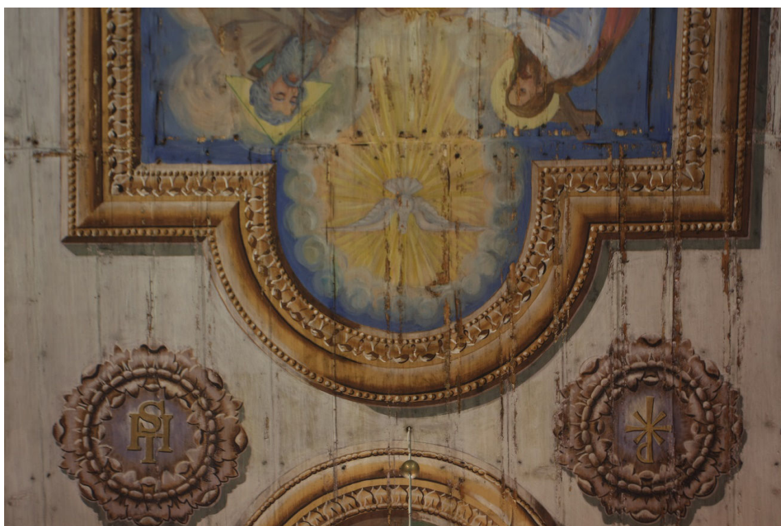
Fot. 24. Kościół p.w. Św. Michała Archaniola w Ropie. Fragment polichromii na stropie fasetowym. Widoczne zniszczenia wywołane przez klej, którym przyklejano pasy płótna a także korozję gwoździ, którymi przybijano deski.
