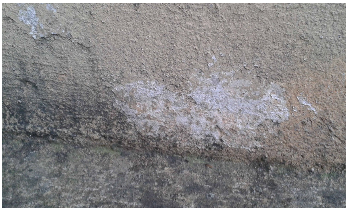
Fot. 9. Kościół p.w. Św. Michała Archanioła w Ropie. Widoczne wysolenia w dolnej części elewacji wież.
