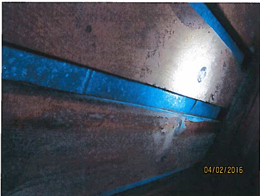
FOT. 8 – Zawilgocenie połaci dachowej - skroplona para wodna na blasze pokrycia dachu oraz rozwój grzyba śladowego ( fac. Peniophora gigantea ) na zawilgoconym deskowaniu. (fot. autor)
