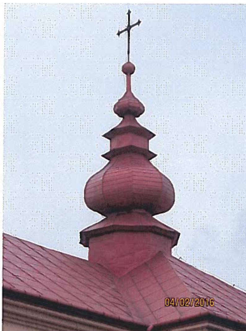
FOT. 9 – Pokrycie dachu - wyraźne deformacje blachy stalowej pokrywającej sygnaturki. (fot. autor)
