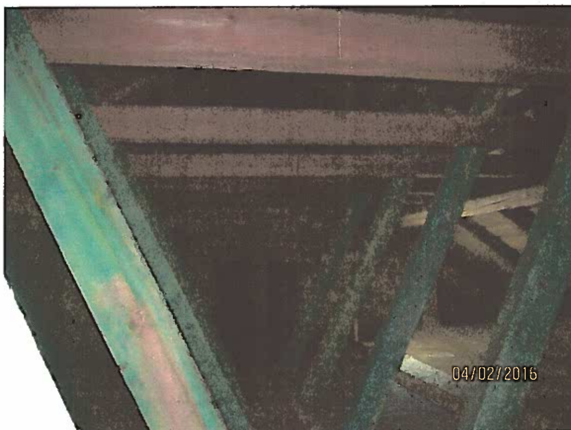
FOT. 2 – Poddasze budynku - widoczne elementy konstrukcji więźby dachowej oraz dodatkowe elementy wzmacniające belki stropu. (fot. autor)
