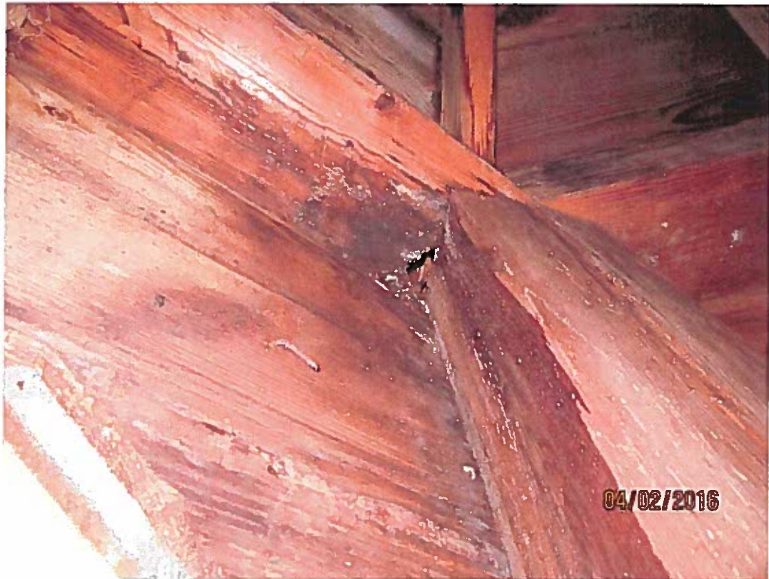
FOT. 7 – Uległe destrukcji elementy drewniane konstrukcji wieżyczki w miejscu połączenia. Rozkład brunatny drewna wywołany atakiem grzyba domowego. (fot. autor).
