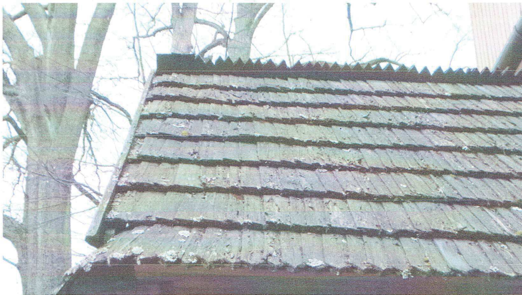
Fot.[5] Korozja pokrycia dachu. Fot. autor.
