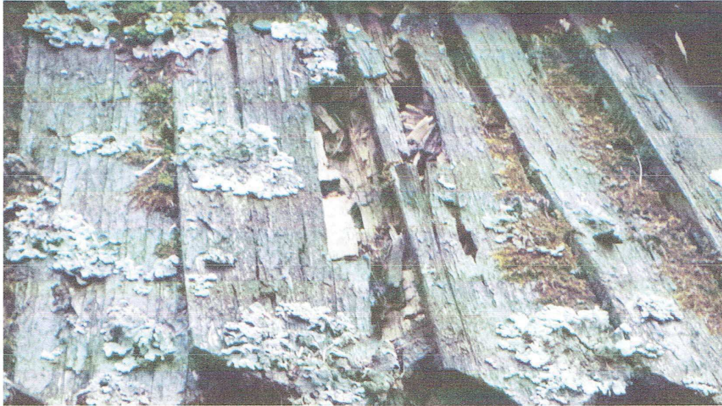
Fot.[6] Destrukcja gontu. Widoczne spękania pryzmatyczne struktury drewna. Fot. autor.
