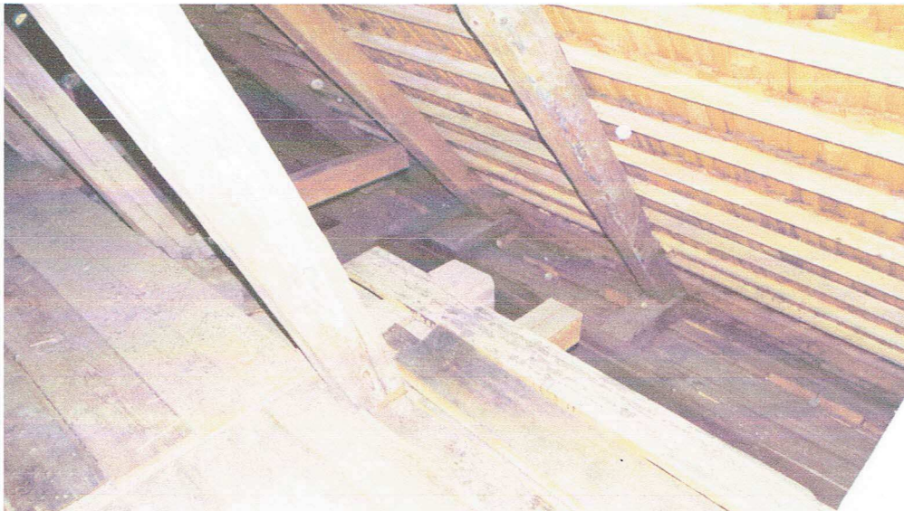
FOT. 6 – Poddasze- widoczny stan zachowania konstrukcji więźby dachowej i pokrycia dachowego. (fot. autor)
