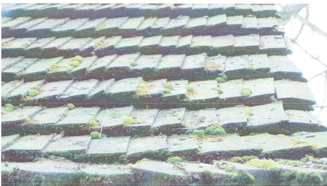
Fot.[8] Korozja pokrycia dachu wywołana obecnością mchów. Fot. autor.
