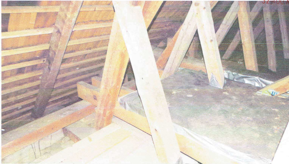
FOT. 5 – Poddasze budynku - widoczne elementy konstrukcji więźby dachowej i platformy na guano dla nietoperzy. (fot. autor)
