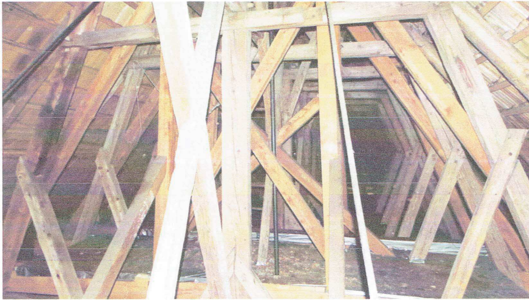
Fot.[10] Wygląd drewnianych elementów konstrukcji dachu z widocznymi uzupełnieniami wymienionych belek. Fot. autor.
