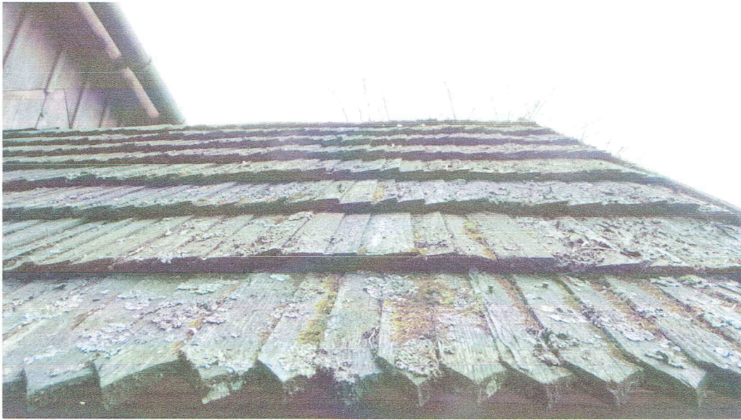
Fot.[8] Korozja pokrycia dachu wywołana obecnością mchów i porostów. Na drugim planie widoczne również rośliny wyższe. Fot. autor.
