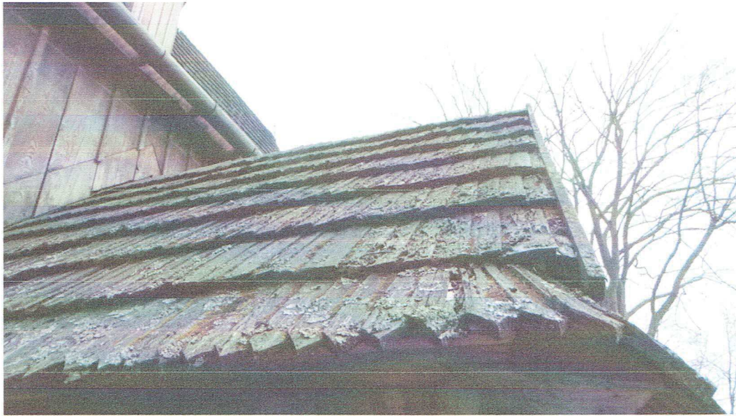
Fot.[4] Korozja pokrycia dachu wywołana przez mchy i porosty. Fot. autor.
