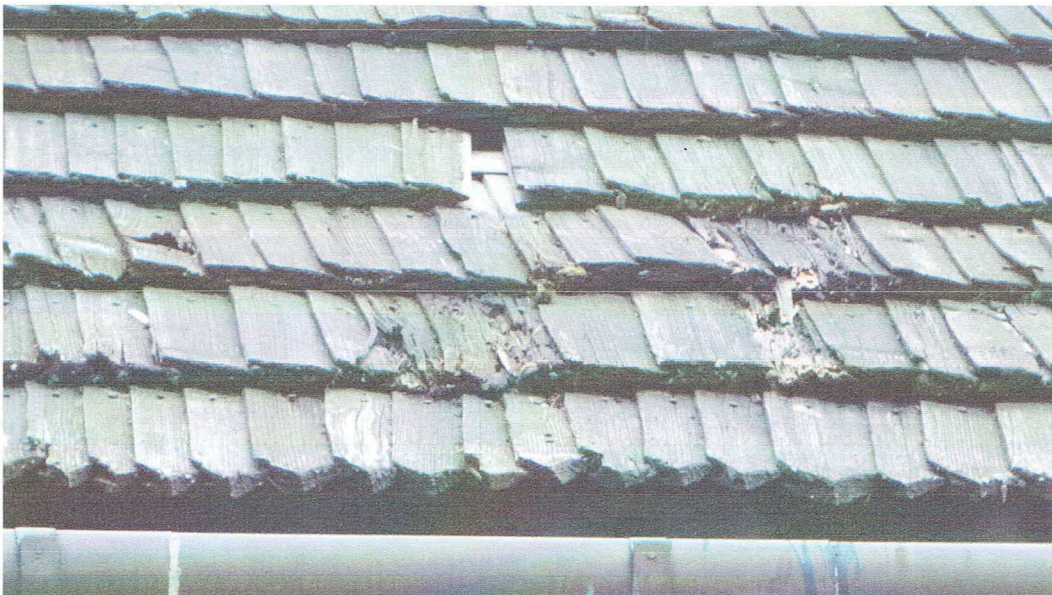
Fot.[9] Liczne ubytki w pokryciu z gontu. Fot. autor.
