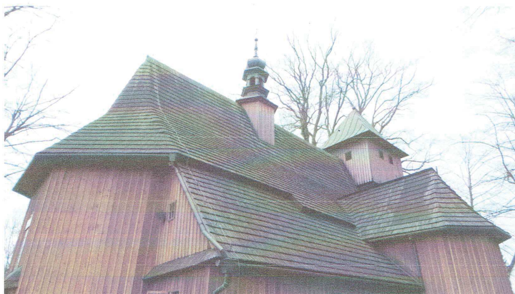
Fot.[3] Rozległa korozja pokrycia dachu – mchy, glony i porosty na elewacji północno-wschodniej. Fot. autor.
